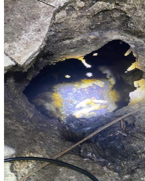
Ruồi cống / Drain flies
