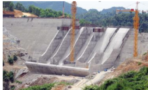
NM Thủy điện Bình Điền Binh Dien Hydropower Plant
