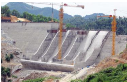
NM Thủy điện Tả Trách Ta Trach Hydropower Plant
